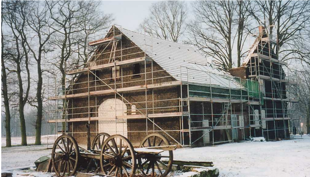
Im Januar 2001 bei Schnee und Eis, Sturm und Frost gab es kein schützendes Dach für die restliche Bausubstanz
